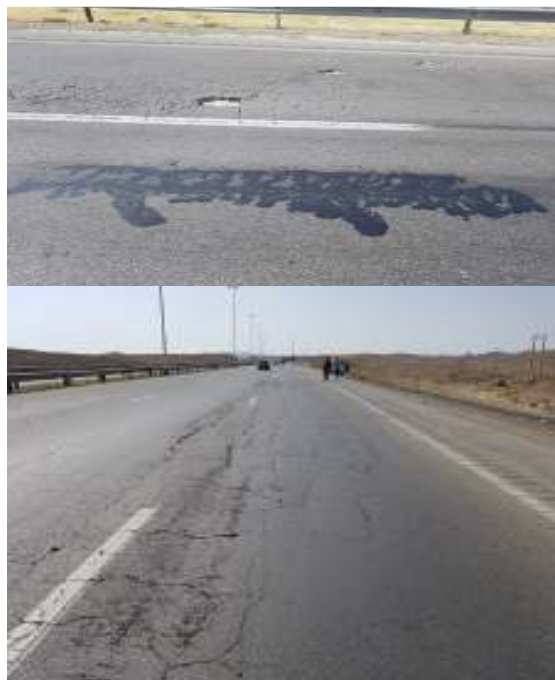
شکل ۲. خرابی‌های مشاهده شده در سه آزادراه کربلا، زال و تهران-قم
