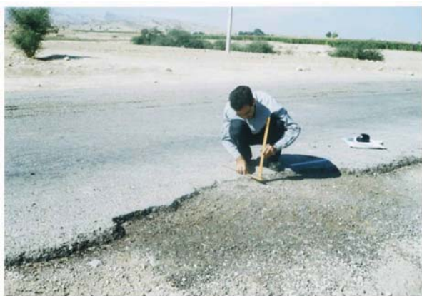
شکل ۳. نحوه اندازه گیری خرابی روسازه
