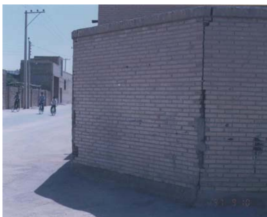
شکل ۳. جابه‌جایی نسبی قسمتهای مختلف دیوار حیاط نسبت به هم و ایجاد گسیختگی در محلهای تمرکز تنش (شهرک امام جعفر صادق)
