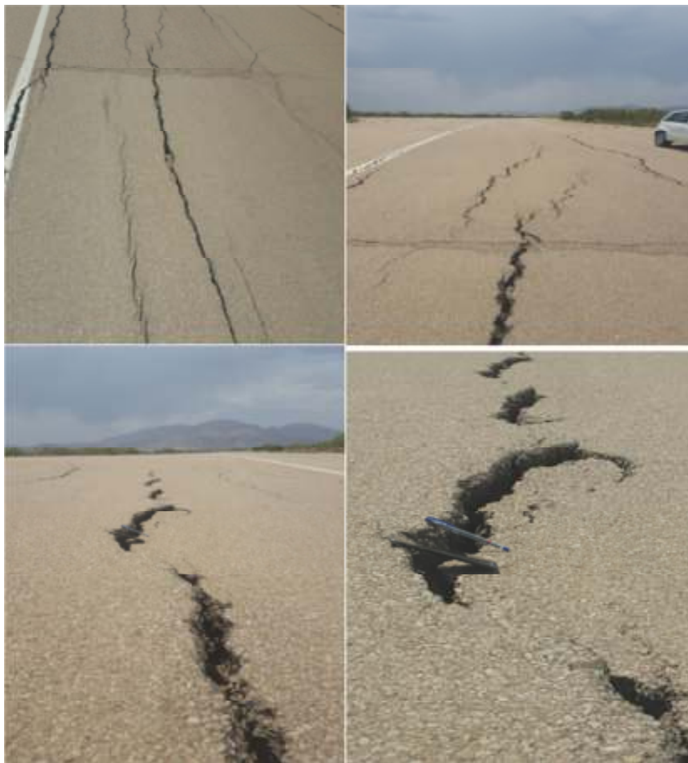
شکل ۱۲. ترک و شکاف و شکستگی در باند Taxi Way
