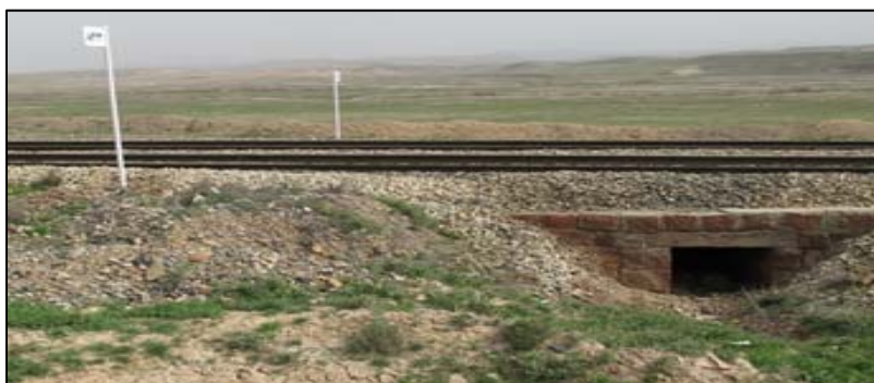
شکل ۲. پل شماره R44 کیلومتر (۸۴۳+۰۰۰) که به واسطه گذشت زمان از کارائی هیدرولیک و مقاومتی آن کاسته شده
